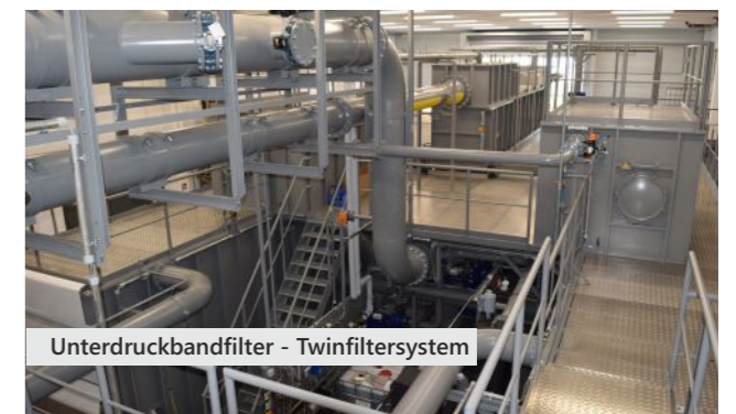
Abwurftrampe des Unterdruckbandfilters
