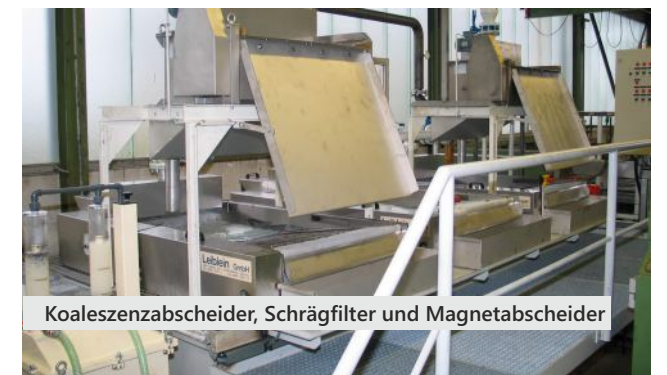
Zentralanlage mit Schrägfilter und Koaleszenzabscheider
