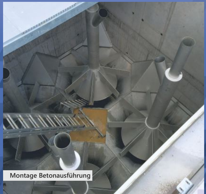
Behälterbauweise in stahlbeschichteter Ausführung
