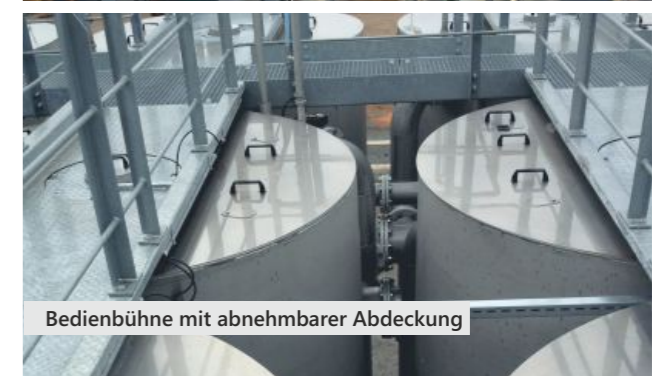
Sandfilter mit Schrägklärer und Flockungstank
