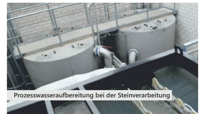
16 Sandfilter mit Schrägklärer zur Washwasseraufbereitung
