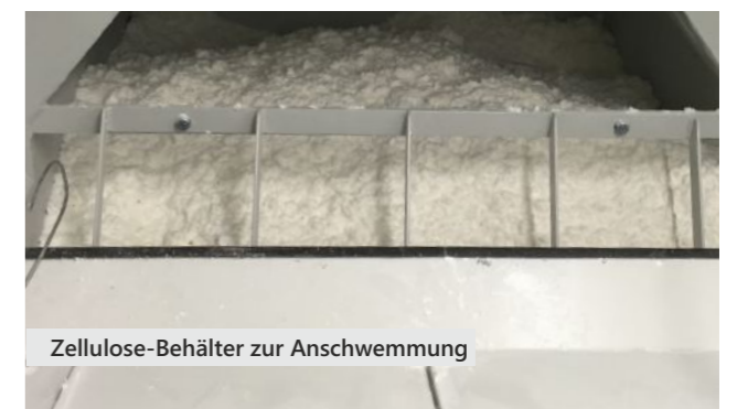
Druckbandfilter bei der Getriebeherstellung
