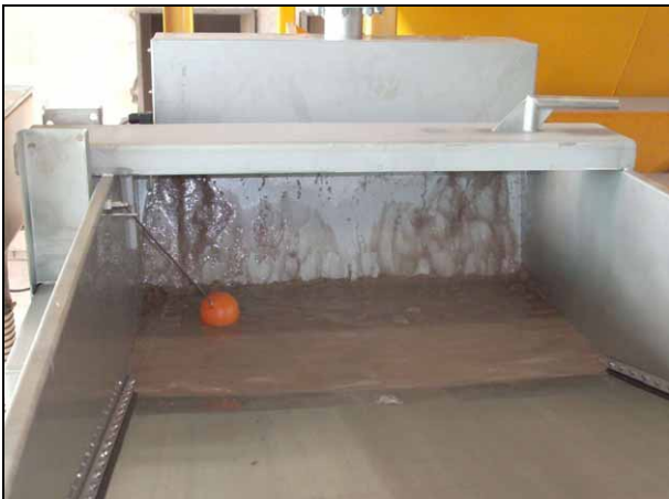
Zulauf Schlamm in Vakuumbandfilter
