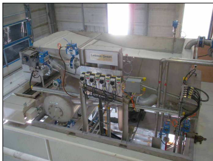
Vakuumbandfilter im Betrieb
