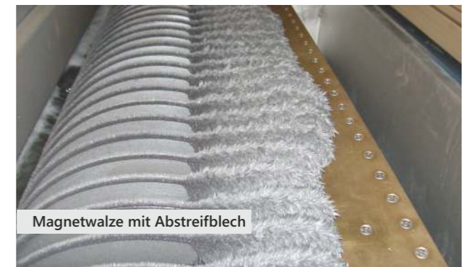
Zwei Magnetabscheider in einer KSS-Zentralanlage
